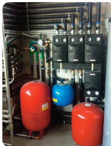
LE TUBAZIONI, i vasi di espansione e il collettore di distribuzione.
