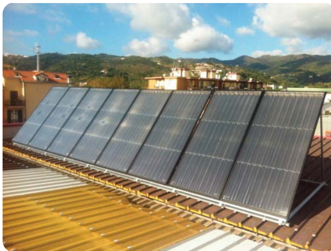
L'impianto solare termico costituito da 8 pannelli solari CPC della Solarfocus
