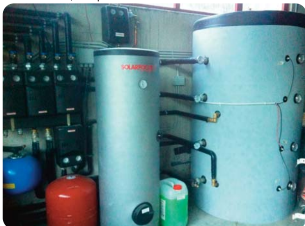
IL BOILER SOLARE bivalente da 300 litri e accumulatore inerziale da 1.500 litri con scambiatore solare.
