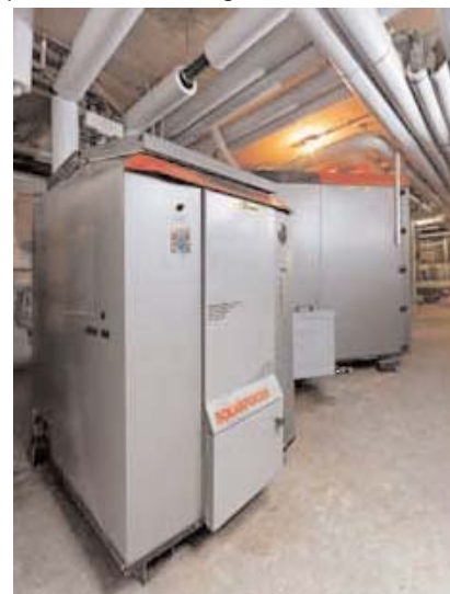
Una caldaia a legna thermi nator da 50 kW verrà in funzione in casi di emergenza (caduta di tensione)
