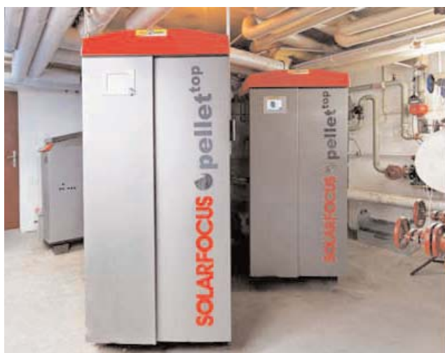
Le nuove caldaie a pellets pellet top con 70 kW ciascuna convincono con tecnologia maturata. Sono il cuore della nuova centrale termica dello Stoderhof.
