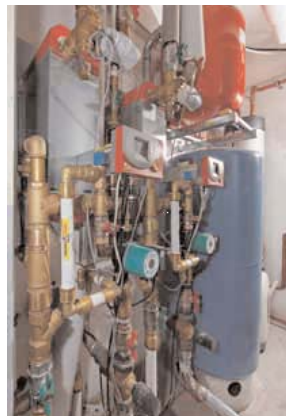
Due moduli ACS garantiscono la produzione igienica dell'acqua calda sanitaria.
