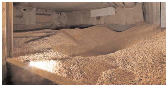
Il vecchio deposito per il gasolio contiene 20 t di pellets.
