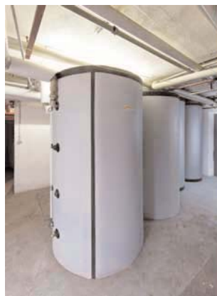
Tecnologia di accumulo con 3 x puffer riscaldamento da 1.250 l e 2 x puffer per l'ACS da 1000 l.
